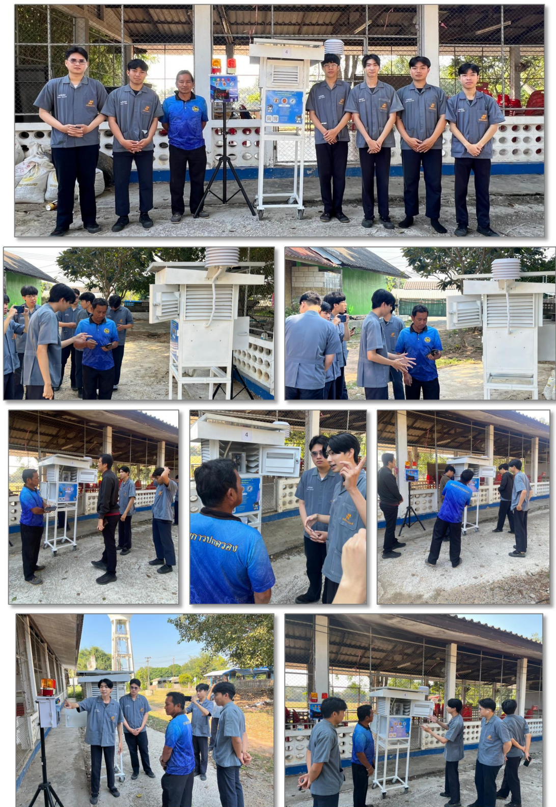
ภาพที่ จ-4 การติดตั้ง “สถานีแจ้งเตือนภัยวิกฤตฝุ่นละอองในอากาศในพื้นที่ชุมชน” ณ หมู่บ้านท้องฝาย หมู่ 11 ต.บ้านกลาง อ.สันป่าตอง จ.เชียงใหม่ ระหว่างวันที่ 2 - 25 ธันวาคม พ.ศ. 2567
